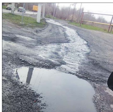
Из-за порывов водопровода вода течёт по улицам, не попадая в дома горожан.
