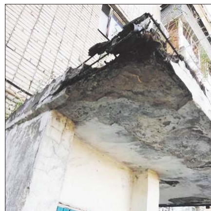
Опасно рушится козырек подъезда. Жители опасаются, как бы все не закончилось трагедией.
