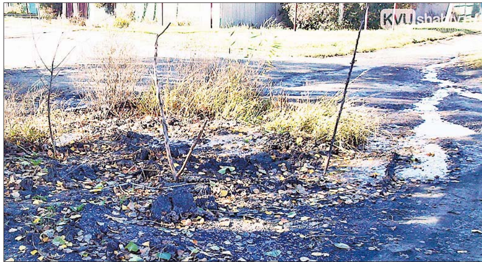
Жители улицы Демьяновской страдают от постоянных порывов водопровода.
