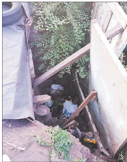
Плохо закрытый водопроводный колодец стал опасной ловушкой.
