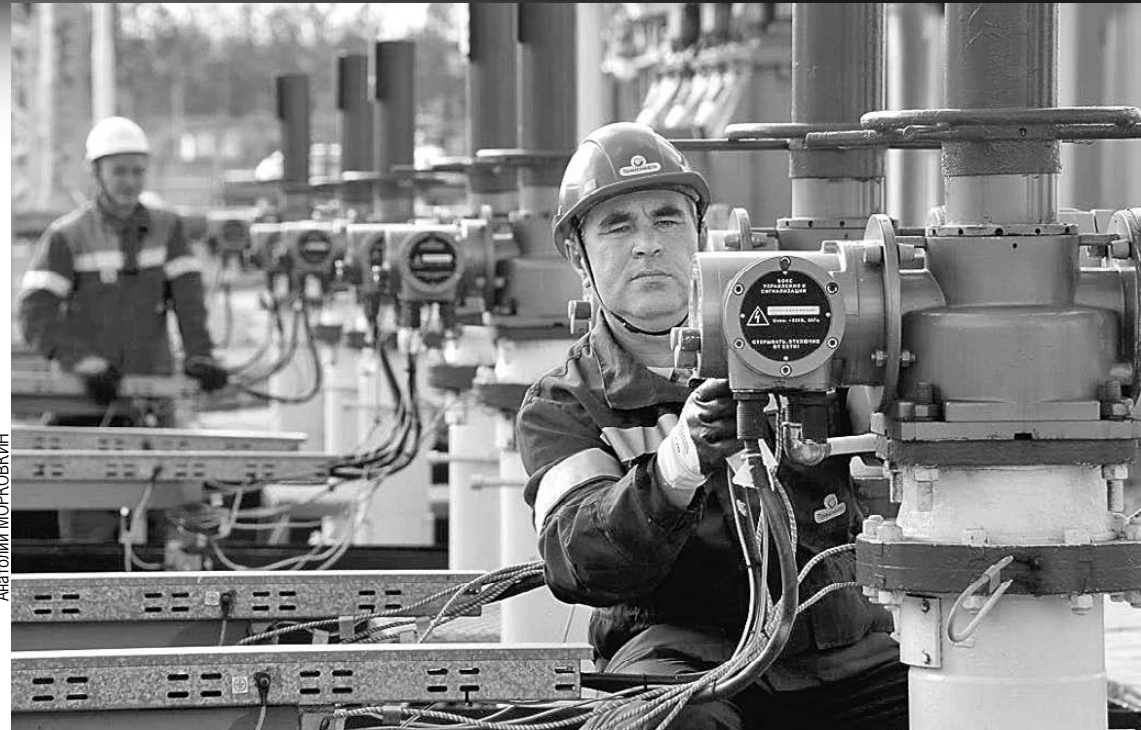
Проверка технологического оборудования на НПС «Сокур». Новосибирское РНУ, АО «Транснефть - Западная Сибирь».
