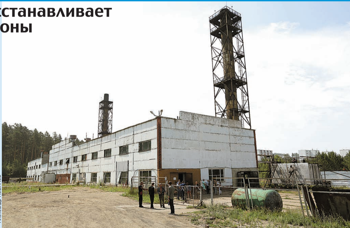
Будет ли тепло в домах городка ракетчиков, зависит от работы этого объекта.
