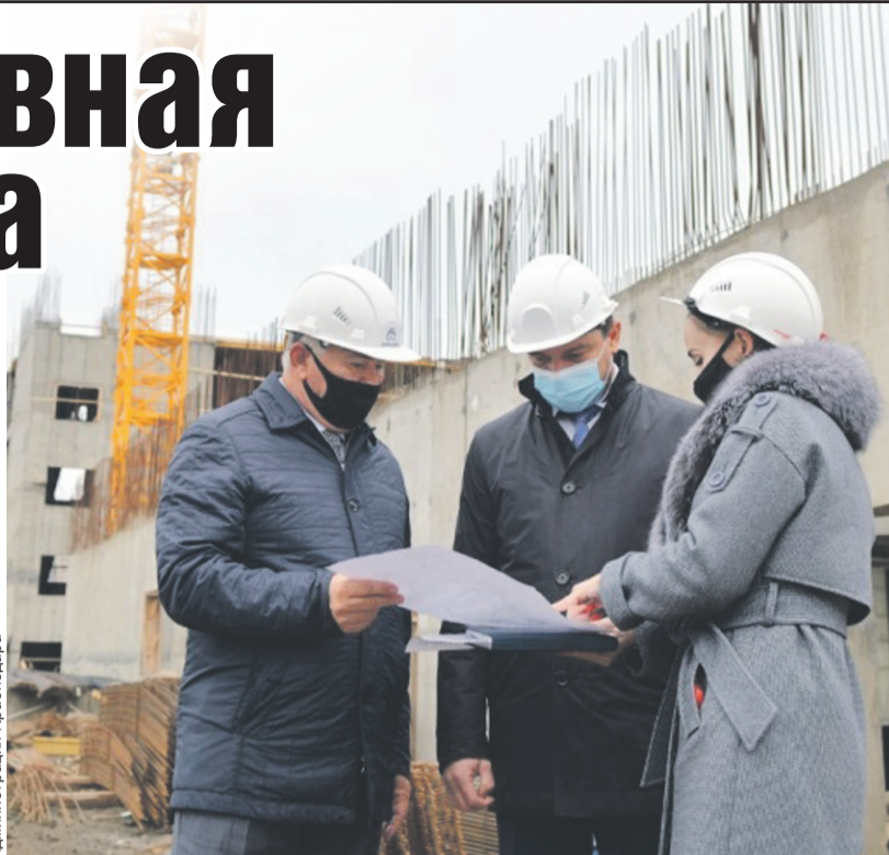
Мэр Евгений Первышов (в центре) ознакомился с ходом работ на строительной площадке.
