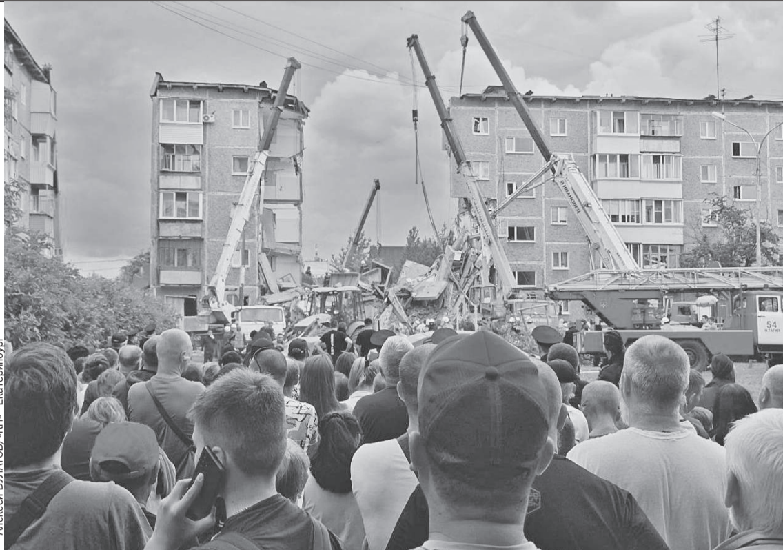
Люди буквально смотрят сквозь дом на соседнюю улицу - от двух подъездов ничего не осталось.
