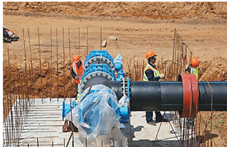
На втором этапе строительства АО «ОЭК» прокладывает тракт водоподачи к Феодосии и Керчи.
