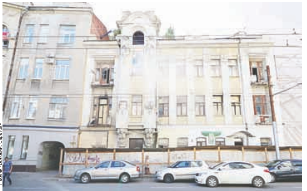
Над домом Яхимовича взял шефство председатель ГД Вячеслав Володин. Памятник архитектуры будут спасать от разрушения.
