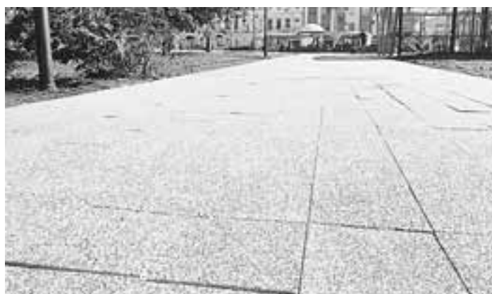
Новая плитка имеет сколы, не везде уложена качественно.
