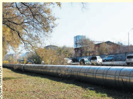
БОЛЕЕ 300 КМ МАГИСТРАЛЬНЫХ ТЕПЛОТРАСС
