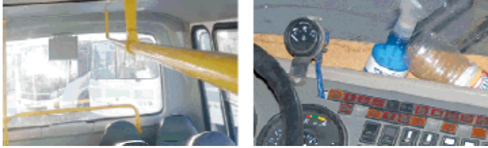
Здесь мастера в автопарке самовольно подсоединили к проводке целых два прибора. Нет ничего плохого в установке дополнительного оборудования...
