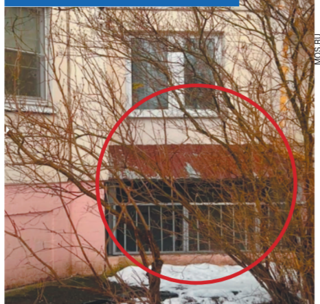
Козырек над подвалом в доме на Изюмской улице (фото слева) признали незаконным балконом. И снесли.
