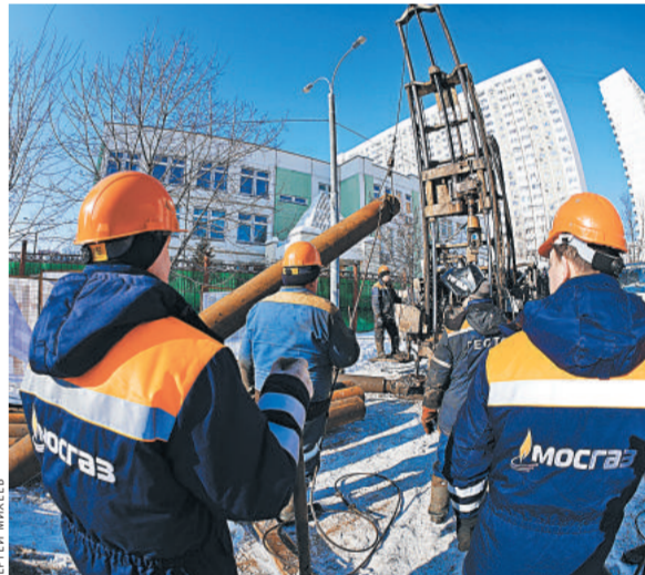
Спасти трубы от разрушения — значит, не допустить аварии.
