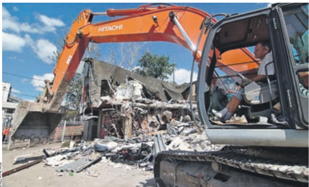
14 августа 2015 года 13:41 Строительный экскаватор сносит незаконно построенный торговый комплекс. На расчищенной территории будет построен транспортно-пересадочный узел
