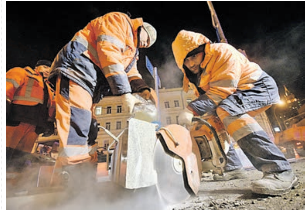
21 апреля 21:27 Рабочие ГБУ «Автомобильные дороги» разрезают ручным фрезером гранитный бордюр, который установят на отремонтированной Каланчевской улице
