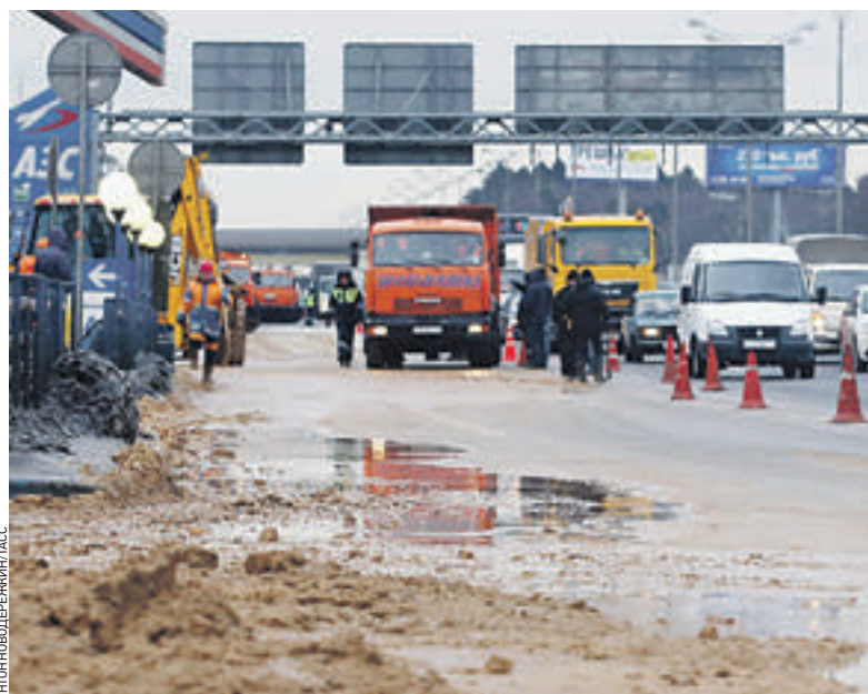
Вчера 12:35 37-й километр МКАД. Сотрудники столичных коммунальных служб ликвидируют последствия прорыва трубы
