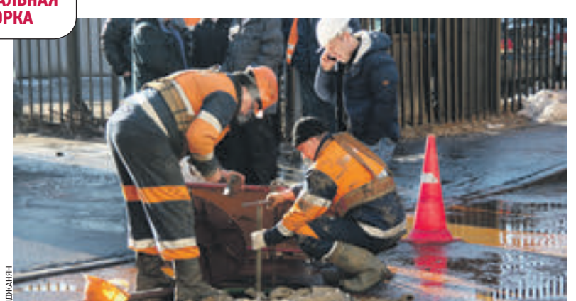
Вчера 10:28 Авария во 2-м Новом переулке привела к тому, что фонтан холодной воды бьет на 2 метра вверх (1) 12:00 Аварийная бригада Мосводоканала устраняет последствия разлива воды напротив дома № 7 (2)
