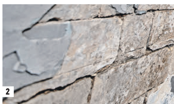
6 августа 11:23 Облупившаяся штукатурка и дыра в каменной оградке Екатерининского дворца в Лефортово (1) Местную жительницу Валентину Чалову удручает плачевное состояние торца здания (2)
