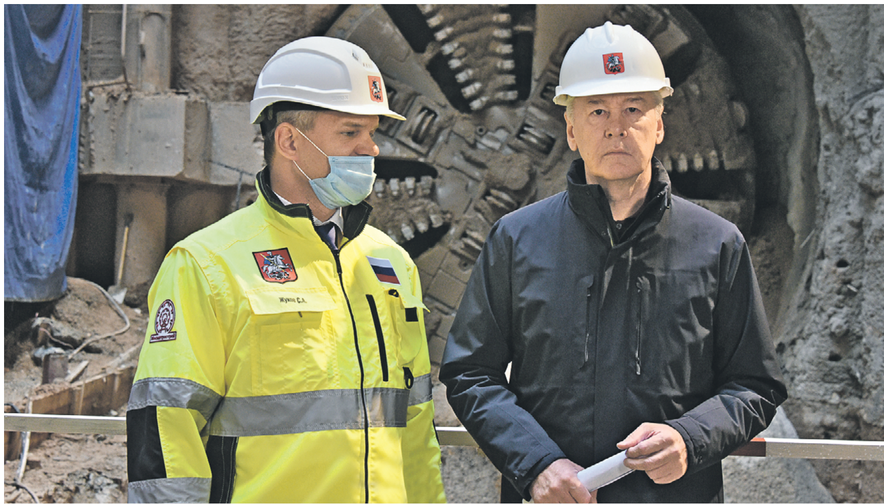
Вчера 11:07 Мэр Москвы Сергей Собянин (справа) и гендиректор компании-подрядчика Сергей Жуков на фоне тоннелепроходческого комплекса «Татьяна» в котловане будущей станции Большой кольцевой линии метро «Рижская»
