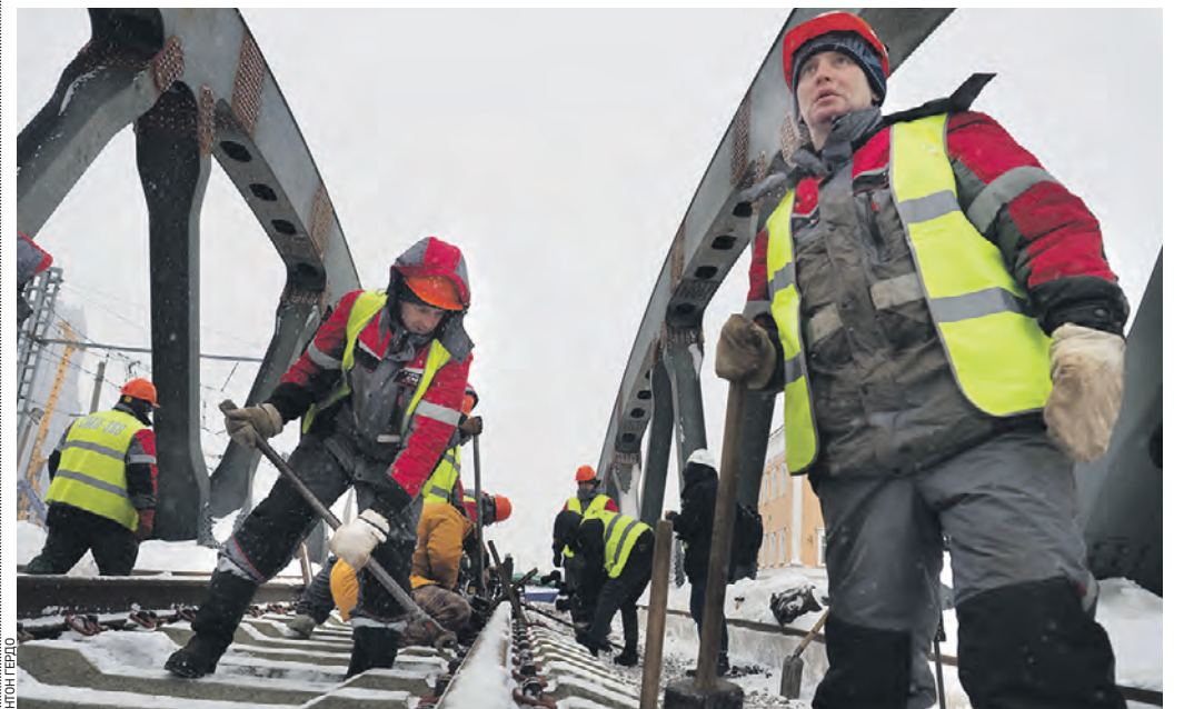
Вчера 11:31 Рабочий Игорь Фатеев (справа) со своими коллегами укладывает шпалы на Каланчевском путепроводе
