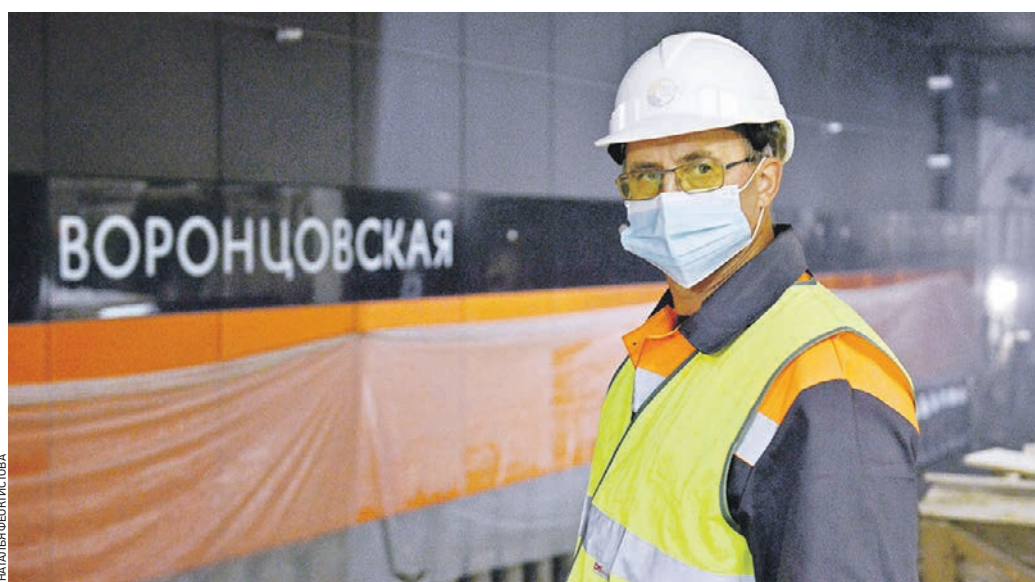
28 августа 11:17 Мастер участка Константин Купцов осматривает ход отделки на станции «Воронцовская» Большой кольцевой линии метрополитена
