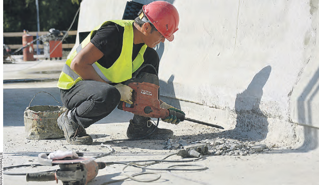
23 августа 2021 года. Рабочий Арсан Хасанов участвует в сооружении Московского скоростного диаметра. Его северный участок готов на 80 процентов
