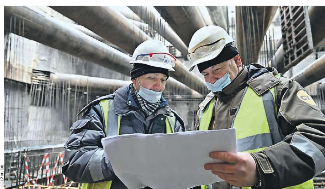
4 января 2021 года 11:10 Представители компании-подрядчика Илья Здобнов (слева) и Евгений Вострокнутов сверяют готовность станции «Кленовый бульвар» БКЛ с проектом
