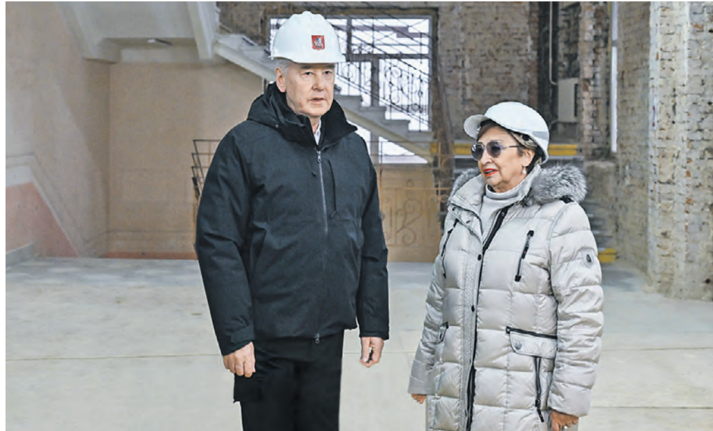
5 ноября. Мэр Москвы Сергей Собянин и директор школы № 1501 оценили ход реконструкции здания на Тихвинской улице. Через год школа откроется в обновленном виде
